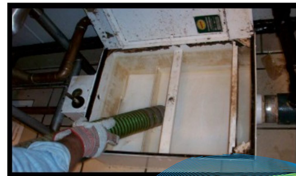
Figure 5. Ejemplo de una trampa siendo limpiada por un contratista. Fuente: Grupo de Prevención de la Contaminación del Área de la Bahía
