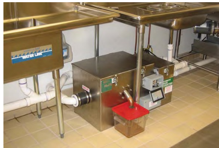
Figura 4. Ejemplo de un aparato automático para la extracción de grasa instalado. Fuente: The Wastewater Solutions Update
